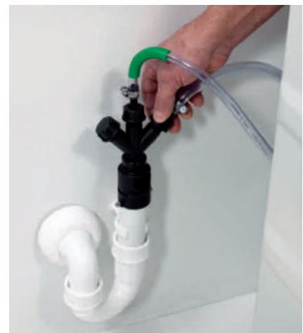
Y un aspecto muy inteligente es que la nueva conexión de drenaje permite la conexión firme y fácil al desagüe.
