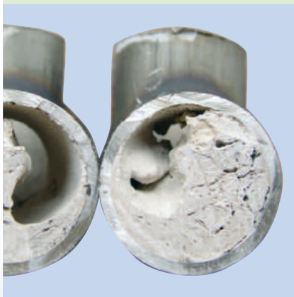
Las incrustaciones de cal causadas por el agua dura pueden obstruir las tuberías al completo
